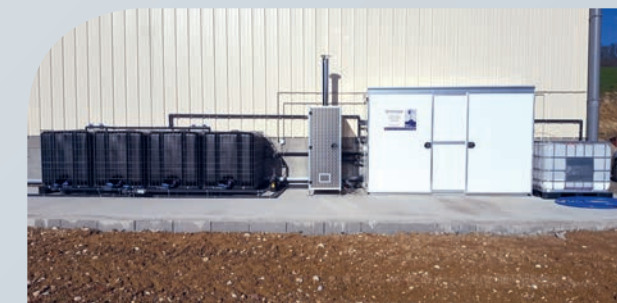
Station de traitement de l'eau (AquaPhyto).
